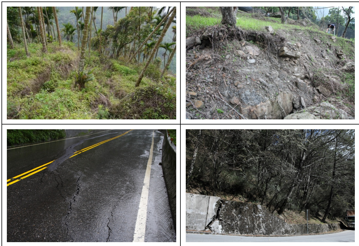
圖 5-4 常見的地表變形現象，係潛在山崩與地滑之徵兆。左上：小崩崖與樹木傾倒；右上：崩崖；左下：張力裂隙發育漸造成道路沉陷；右下：擋土牆破壞外推。
