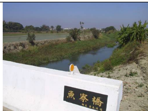
照片 14：魚寮橋，95 年 9 月改建完成，惟上下游土堤高度不足，常發生洪水溢堤淹沒兩岸作物造成損失。
