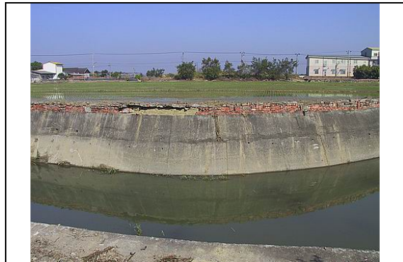
照片 26：護岸高度不足，農民自行堆置紅磚加高，如竹圍後中排一、二出口附近以及後壁排水上游侯伯橋附近。
