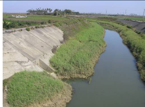
照片 12：菁寮排水閘門附近堤防高度未達 25 年不溢堤保護標準。
