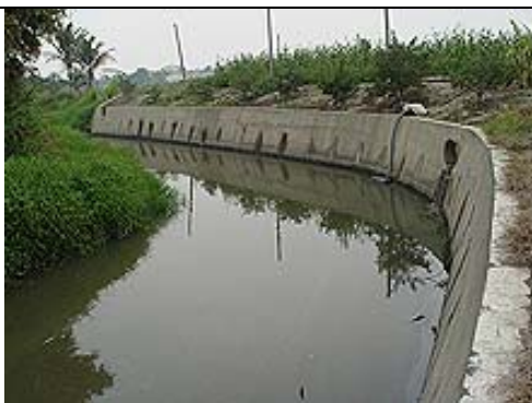
照片 13：菁寮排水路凹岸，由於角度過大導致水流轉向超高影響，洪水位常高過護岸。
