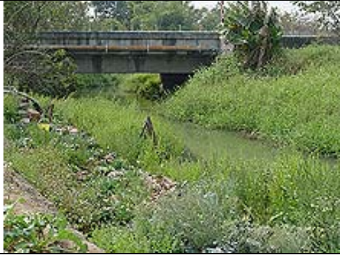
照片 5：南 78-1 線後鎮橋，地勢低窪且排水路容量不足
