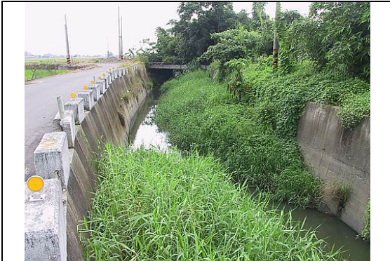
照片 23：排水路內淤積造成雜草叢生，若未於雨季前清淤疏浚，則容易減少通洪斷面。
