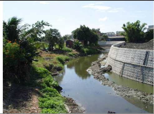
照片 8：新東村南側，排水路北岸新設護岸工程，排水路南岸土堤低矮，大雨期間有崩塌阻塞排水路之虞。
