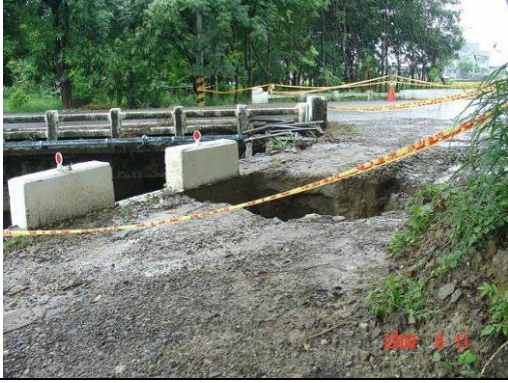
照片 27：0609 暴雨，南 82 線菁寮排水護岸遭洪水淘刷，路基流失。
