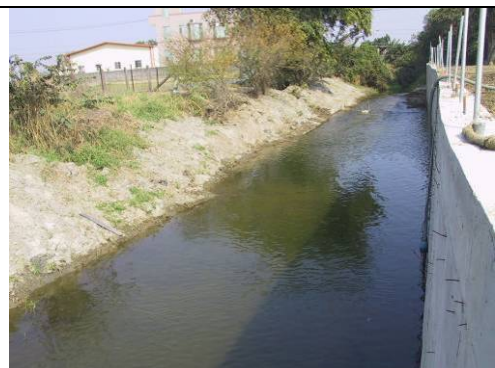
照片 4：後鎮橋上游新營市公所護岸工程施作中，惟對岸屬後壁鄉公所，並未一併施作，有溢堤之風險。
