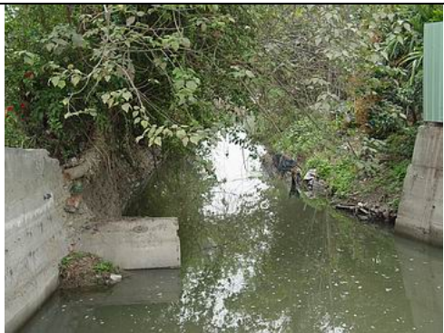
照片 9：下茄苳排水進入嘉苳村後護岸老舊，且新舊高度不一，接縫參差不齊。
