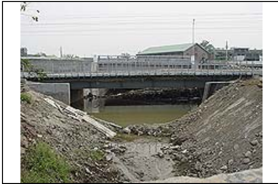
照片 17：後壁排水穿越台一線與縱貫鐵路之涵洞及下游排水路護岸已改建完成，惟銜接處約 15m 尚未完成改建，造成排水瓶頸。
