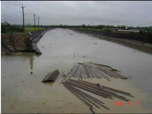
照片 29：0609 暴雨，後鎮排水溢堤淹沒竹新村竹圍後道路。
