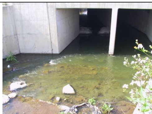
照片 3：因配合高速公路拓寬工程，後鎮排水路流經高速公路處之涵洞已改建完成，但涵洞內混凝土塊未清除，有阻礙水流之虞。
