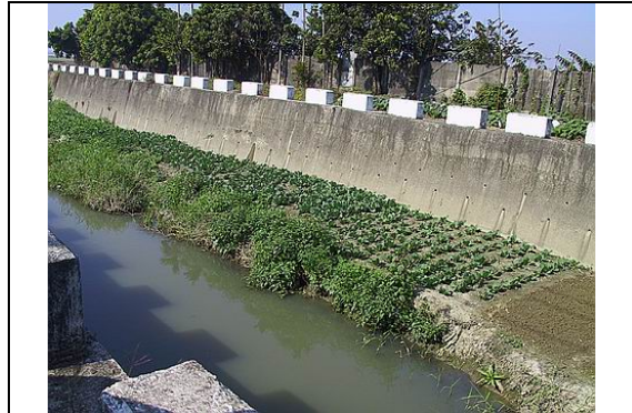
照片 24：佔用排水路作為己用，減少排水路通洪斷面，建議相關單位加強管理查核。
