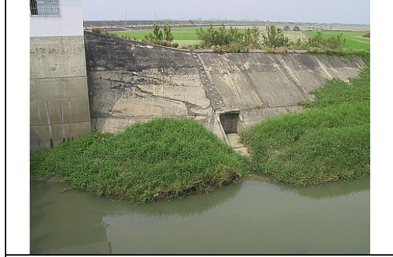
照片 22：區內低地排水出口相對於往往已接近常水位，稍有豪大雨水位升高後，自動閘門關閉即無法排除內水。
