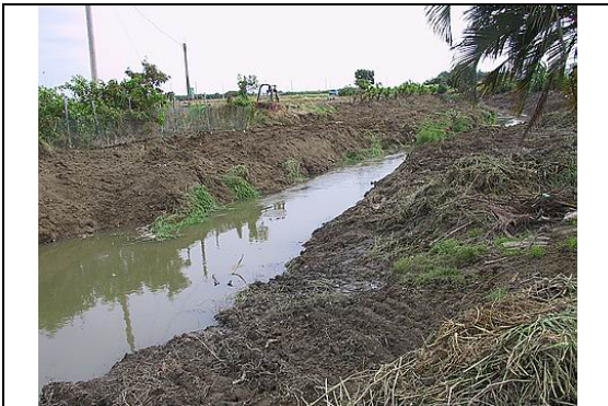
照片 25：護岸高度普遍不足，部分河段久未整建，常有坡面土石崩落之情事發生，如魚寮橋、新頂橋上下游。
