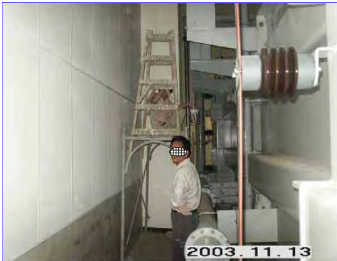
照片 11：施工架上違規設置合梯從事油漆作業。
