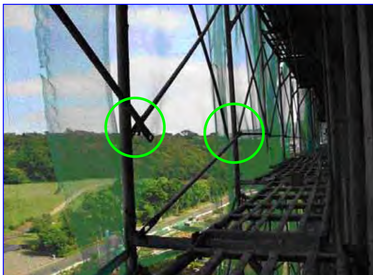
照片 7：作業勞工倚靠在交叉拉桿上，因交叉拉桿扣釘腐蝕而破壞，造成墜落死亡。
