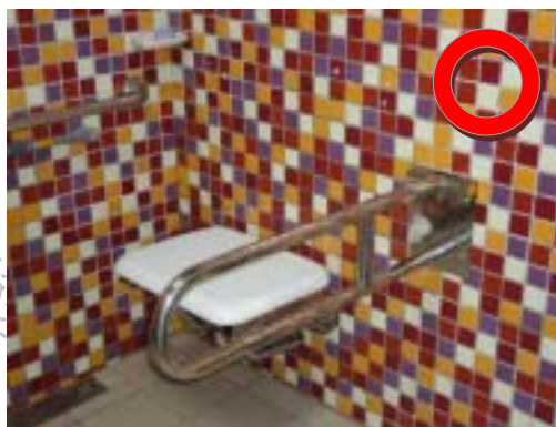
輪椅進入式淋浴間入口側邊座椅處設置可動扶手
