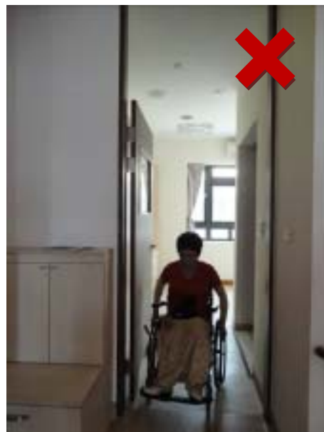
推開門未留設輪椅操作空間，使輪椅不方便進出。
