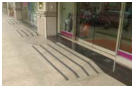
平台深度不足
