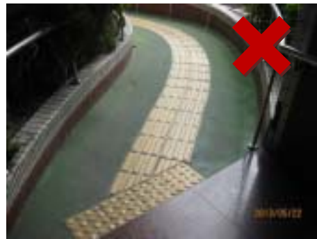
坡道地面不得設置導盲磚妨礙輪椅之通行。
