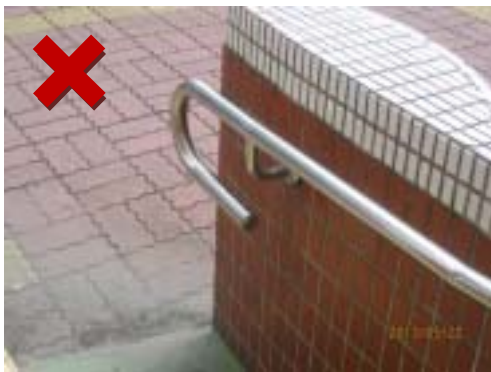
扶手端部未做防勾撞處理，視障者易勾住衣物。
